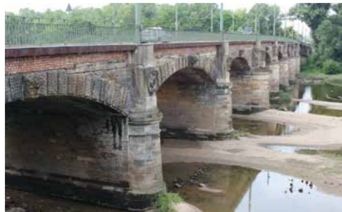
Die beim Elbhochwasser 2013 stark beschädigte Anna-Ebert-Brücke soll wieder ihr ursprüngliches Erscheinungsbild erhalten. Foto: Sven Bardua, 2014
