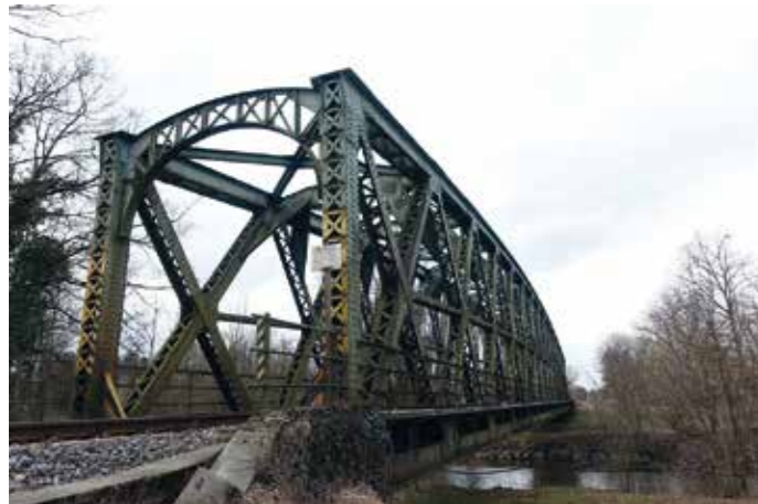
Bei der Eisenbahnbrücke in Langenargen leiten kräftige portalartige Endständer die Belastungen aus dem oberen Windverband und dem Obergurt an die Auflager weiter. Foto: Anita Kuisle, 2019
