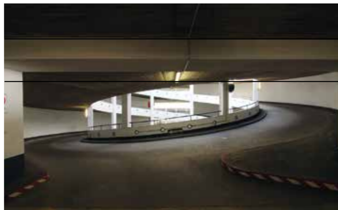
Die funktional gestaltete Doppelwendelrampe des Parkhauses Rödingsmarkt in Hamburg beeindruckt die Besucher mit ihrem ästhetischen Reiz. Foto: Sven Bardua, 2016
