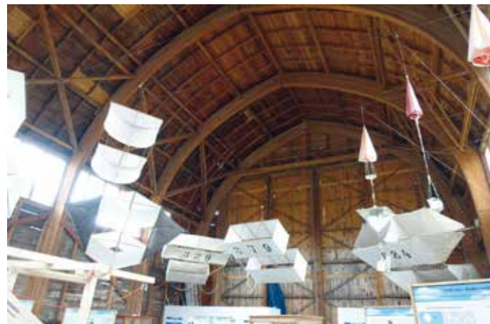
Die 1936 erbaute Ballonhalle des Wettermuseums in Lindenberg besticht mit ihrer freitragenden Konstruktion. Foto: Volker Mende, 2019
