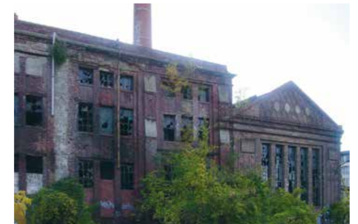
Seit etwa 25 Jahren ist die Eisfabrik am südlichen Spreeufer in Berlin-Mitte dem Verfall ausgesetzt. Foto: Nicor / Wikimedia Commons, 2007
